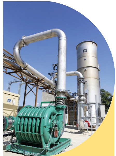
Installation de biogaz du site du Vigeant - 86 [groupe Sèché Environnement]
