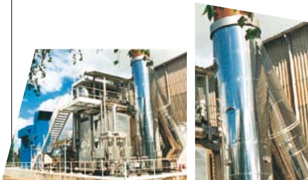
Installation de cogénération Bonilait Protéines (86)
