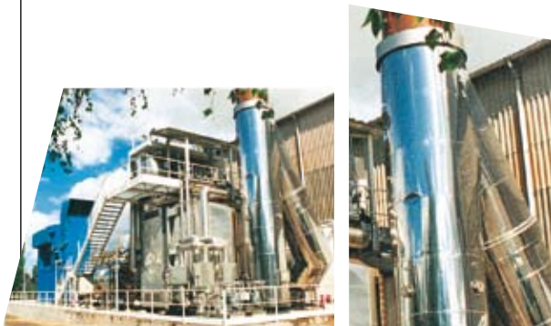
Installation de cogénération Bonilait Protéines (86)
